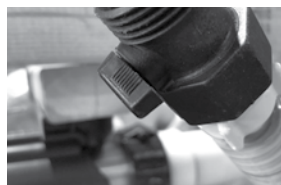
Une fois que votre spa a été drainé, tordre la languette à la position fermée. Retirez votre tuyau d'arrosage, puis remplacez le capuchon du connecteur et fermez simplement la porte de l'armoire
